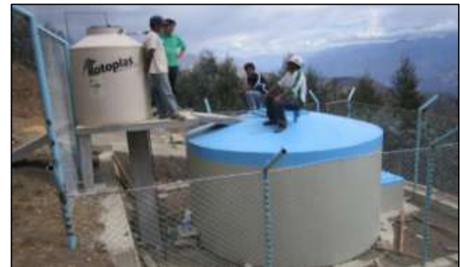
Sistema de agua – Pueblo Nuevo
